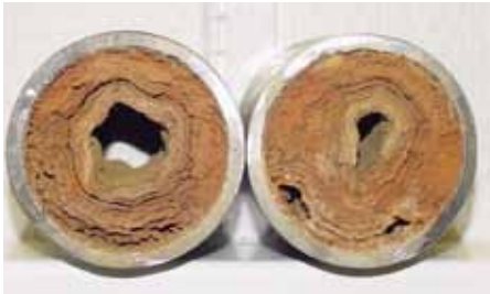
80% torudest vahetatakse katlakivi pärast, toru ise on tegelikult korras.
