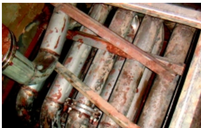
Asi Rudus Eesti Lagedi betoonitehase katla Bauer-töötuse toimel puhastunud leektorud
